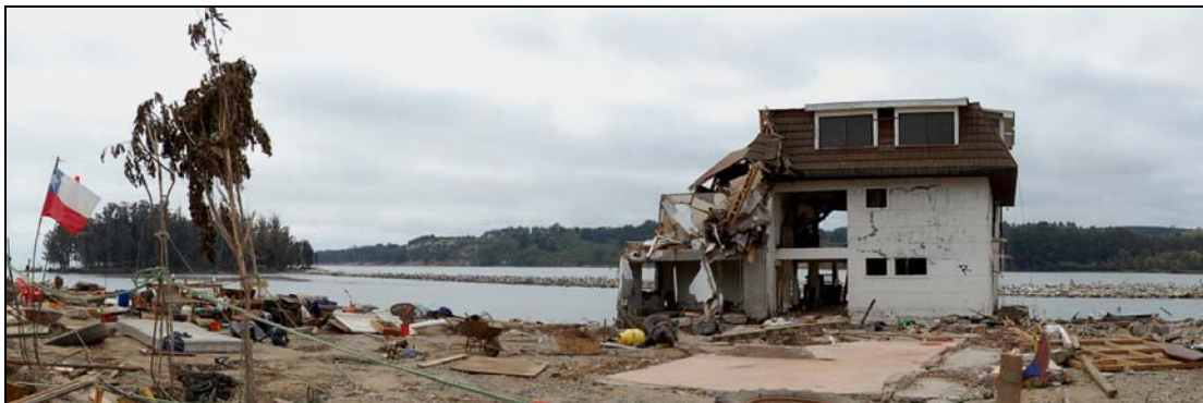
Figura 3-5: Falla en casa ubicada en la ribera del Río Maule, VII Región.
