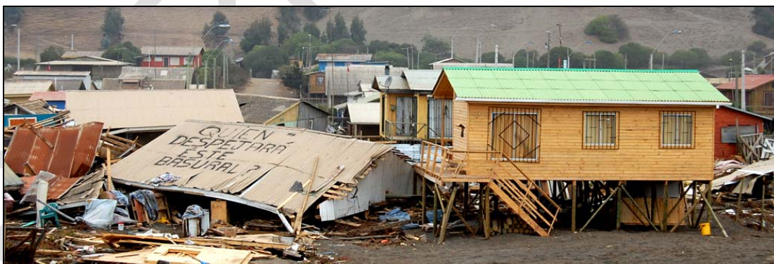
Figura 3-4: Falla de diferentes tipologías estructurales en Iloca, VII Región.
