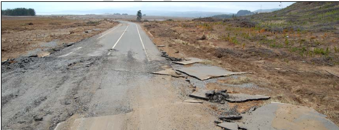
Figura 3-13: Falla del camino costero en La Trinchera, VII Región.
