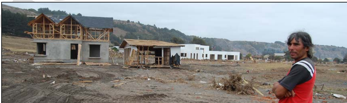
Figura 3-9: Restos del segundo piso de una vivienda de madera desplazada desde su posición original y vivienda con primer piso en construcción en Iloca, VII Región.
