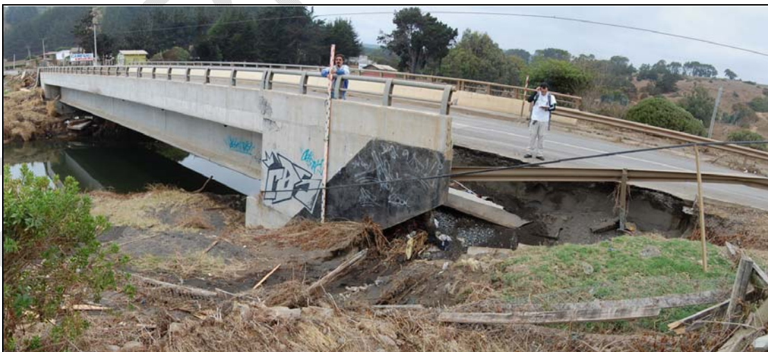
Figura 3-2: Falla por socavación del estribo del Puente Iloca, VII Región.
