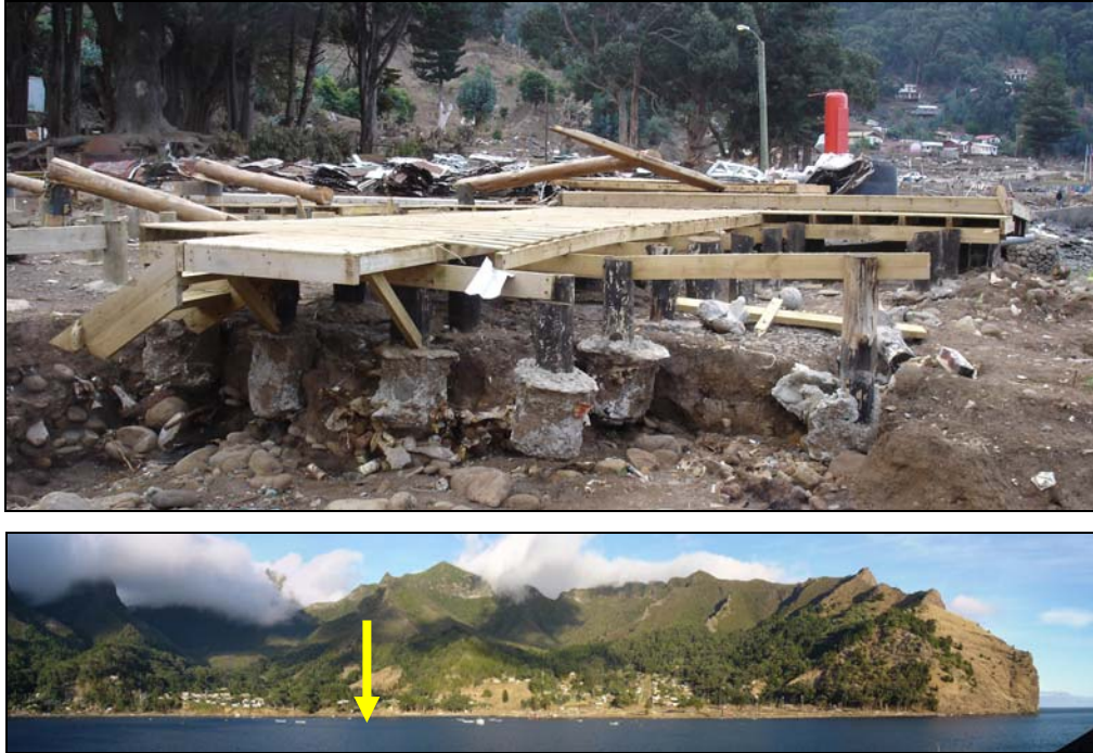
Figura 4-3: Socavación de fundaciones en el Pez Volador, cerca de la rampa.
